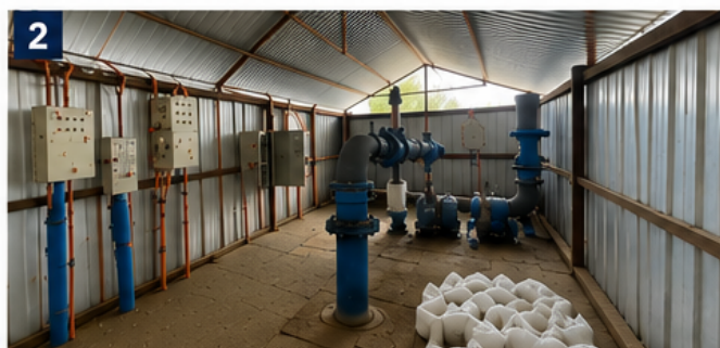
SALA DE BOMBAS Y EQUIPAMIENTO
